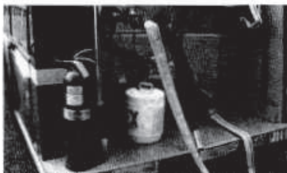
Instalación completa del sistema de producción de espuma
